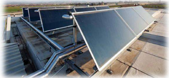
Solare – 50 m 2 → 60% fabbisogno acqua calda sanitaria
