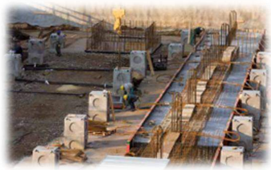
Geotermico – 51 pozzi (100 m) → >30% fabb. climatizzazione
